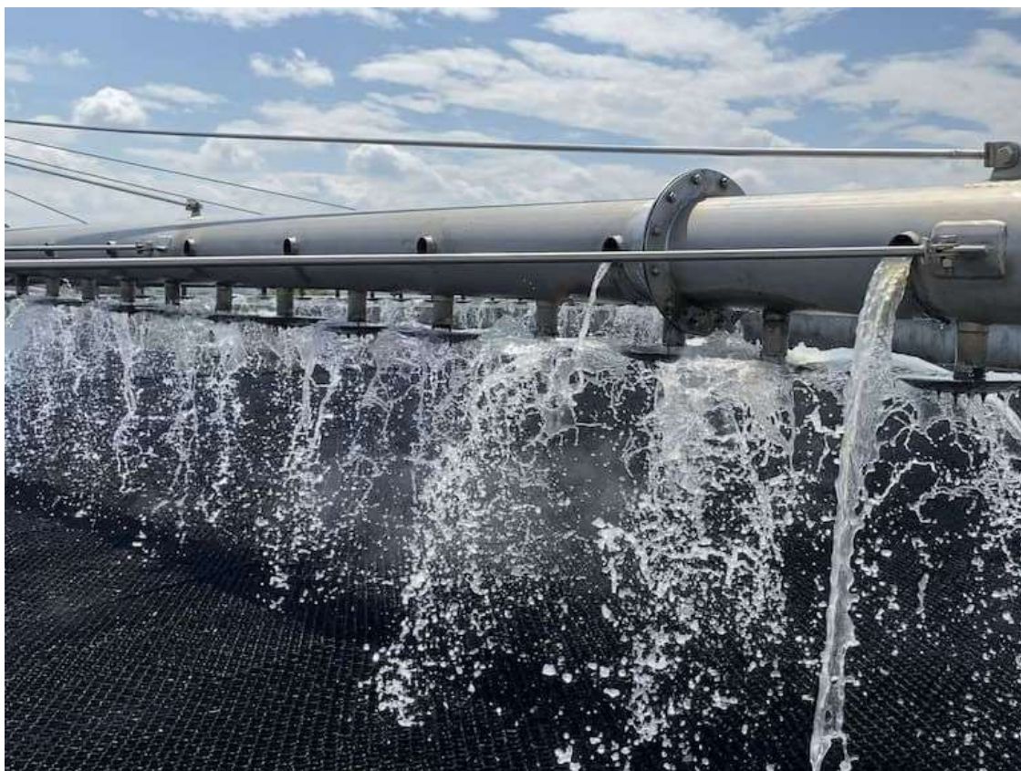
Planta de Tratamiento de Aguas
